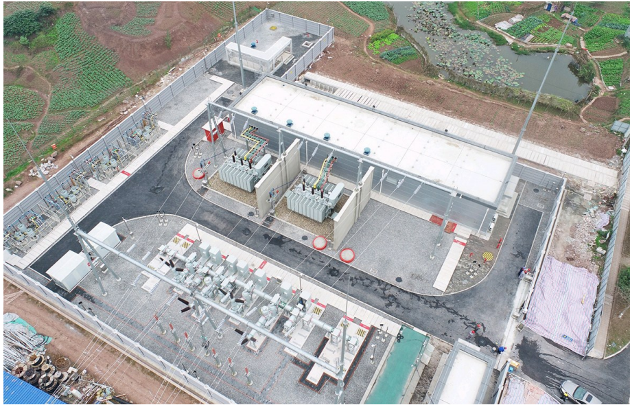
成功投运的110千伏五尊智能变电站。
