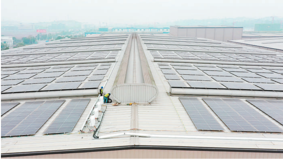
庆兰楼顶的光伏板。
