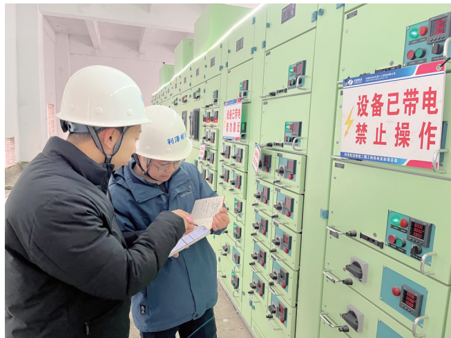
▲检查电力设备
