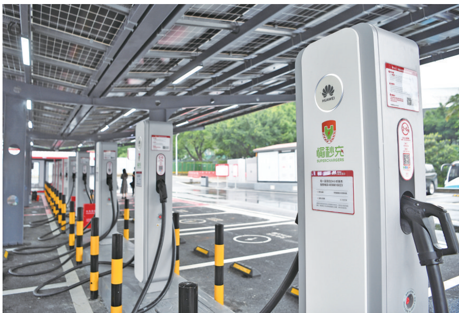
愉秒充奥体金龙全液冷超充站。
