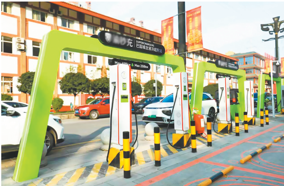
位于巴国城的全液冷超充站。
