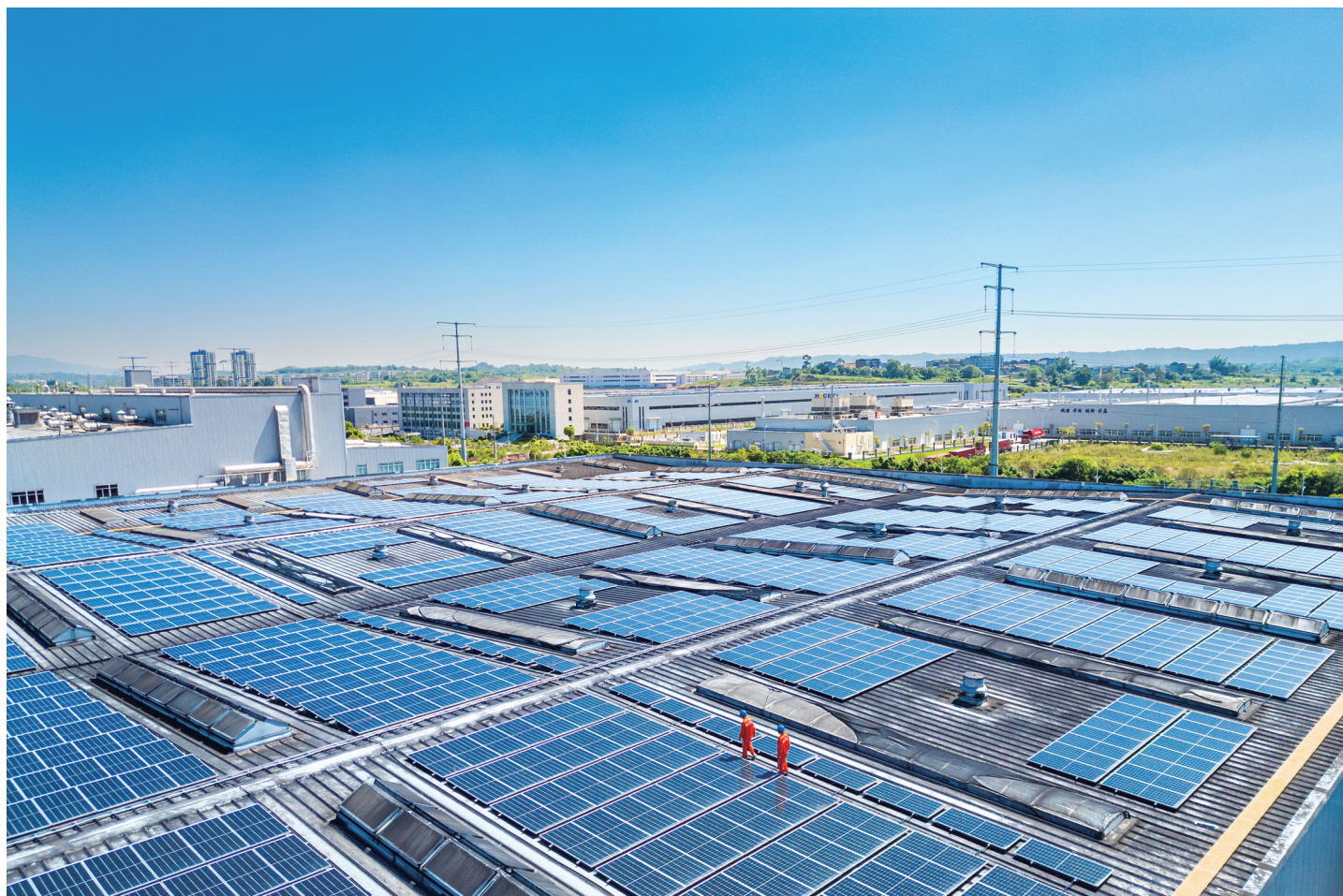
长城汽车重庆分公司屋顶分布式光伏发电项目进入收尾阶段,技术人员正在进行巡检。
