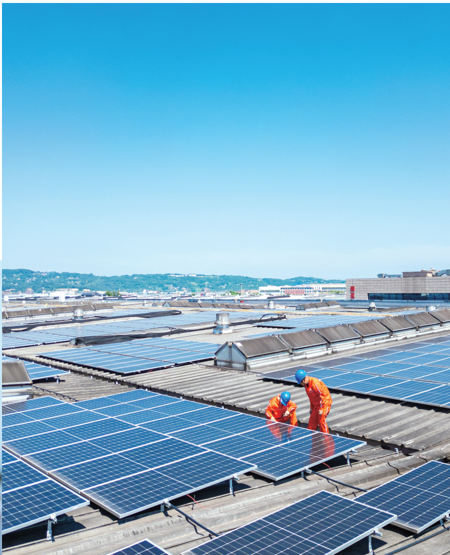
在长城汽车重庆分公司屋顶巡视光伏发电设备。
