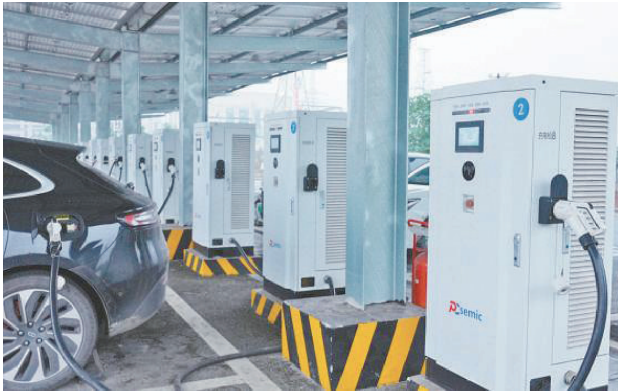
北环路光储充检换一体站
