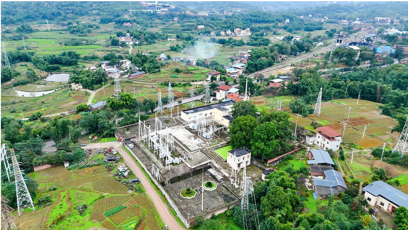
如今的110千伏园通变电站全景
