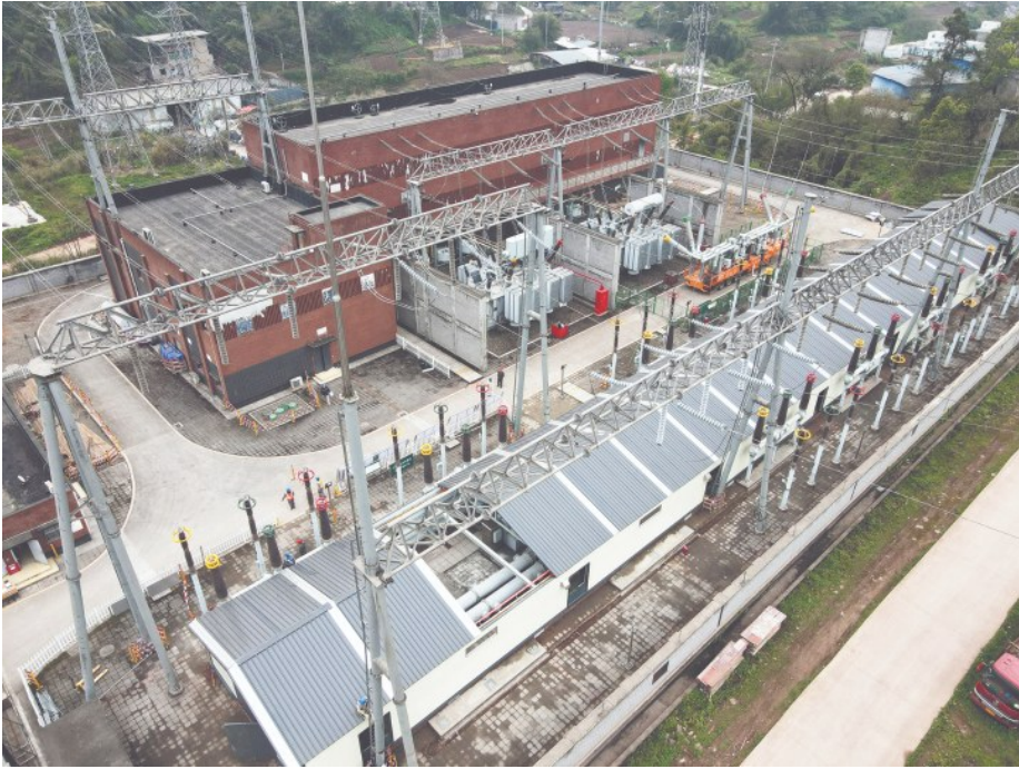
西南首座全封闭智能 GIS 防护装置在巴南区虎啸变电站投运。
