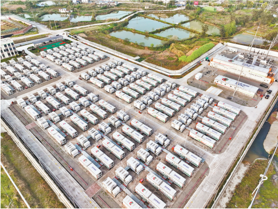
双槐电厂旁的新型储能电站正发挥储能功能。(摄于4月18日)
