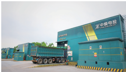
中际新能源电动重卡正在换电。
