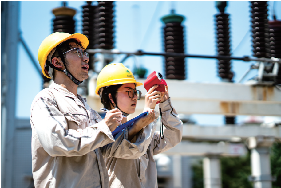
运维人员巡检记录变电站情况。
