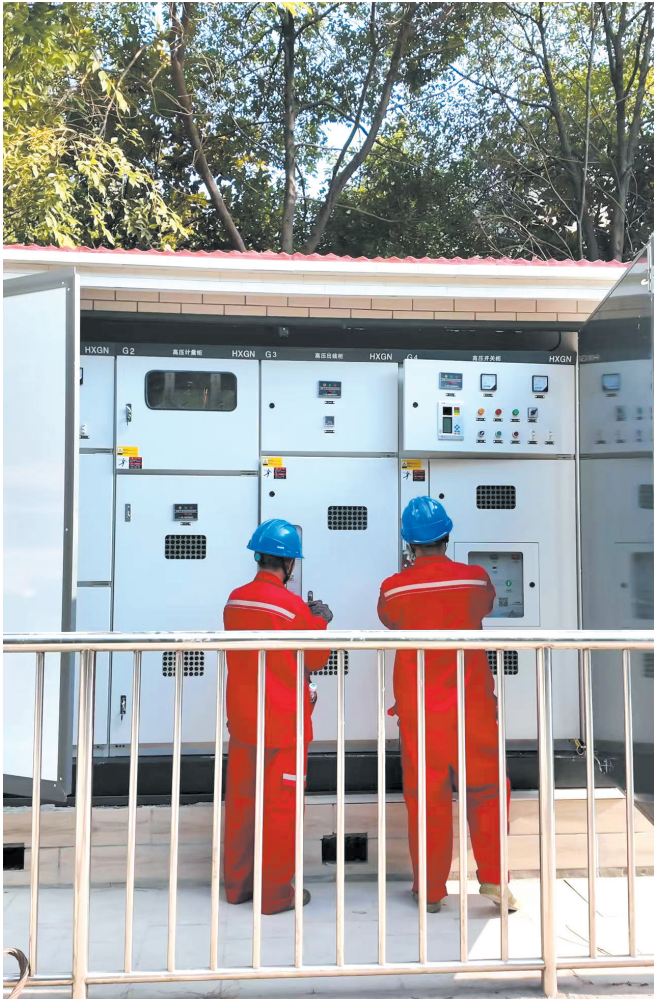
电力工作人员在红河小学检查电力设备。
