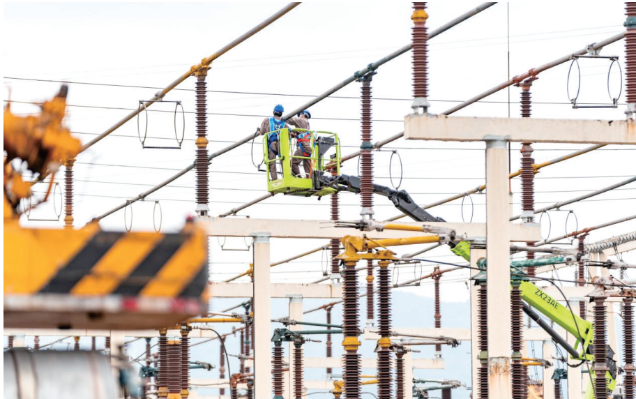
工作人员在220千伏邮亭变电站检修。
